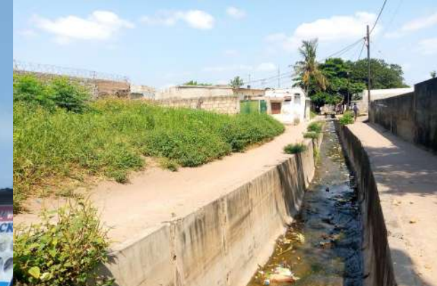
Imagem. 18- Sistema de drenagem que conecta o sistema da Av. Milagre Mabote e Acordos de Lusaka. Fonte: Autor.
