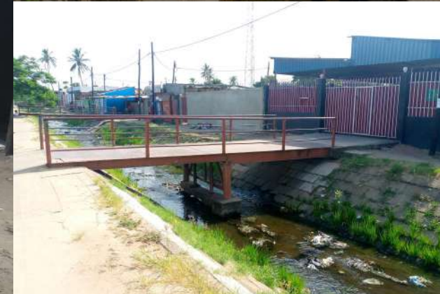
Imagem. 19 - Sistema de drenagem na Av. Acordos de Lusaka. Fonte: Autor.
