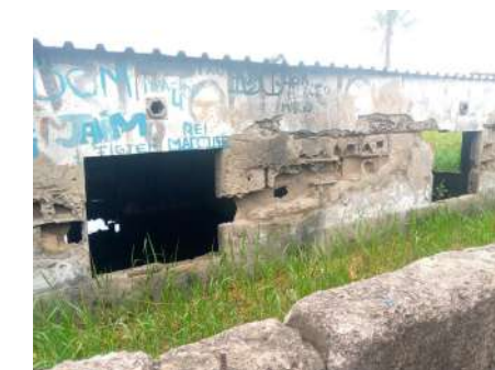
Imagem. 38 - Casa Degradada Espaço Público 2.
