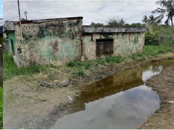
Imagem. 37 - Casa Degradada Espaço Público 1, Drenagem Natural. Fonte: Autor.
