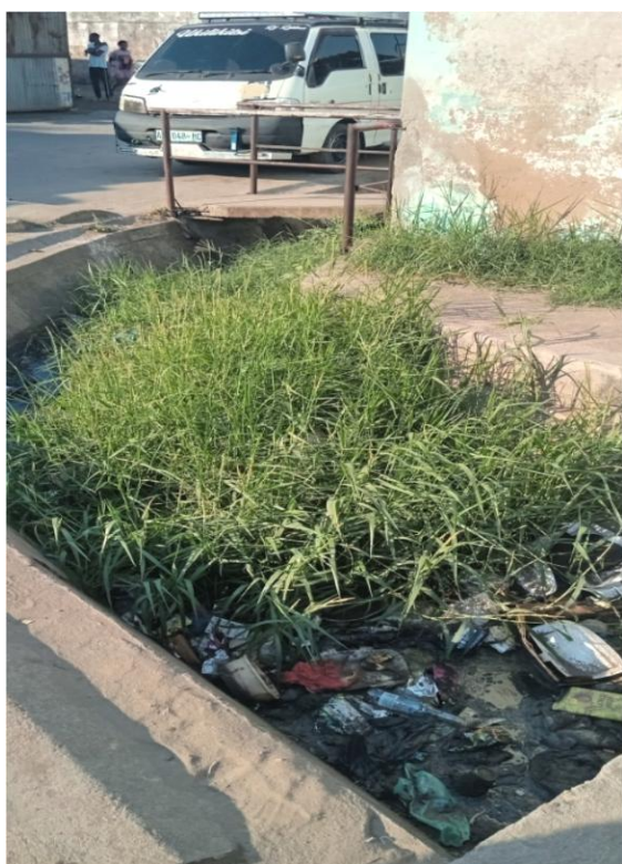
Figura 2: crescimento de vegetação no interior das valas de drenagem no quarteirão 2
