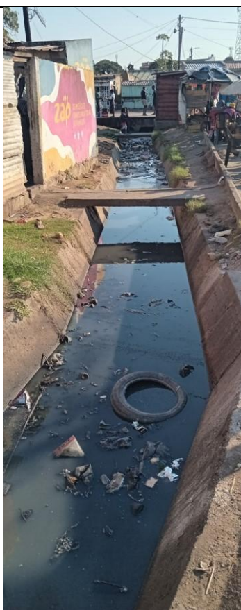
Figura 5: degradação da estética devido descarte inadequado do resíduos sólidos, no quarteirão 3
