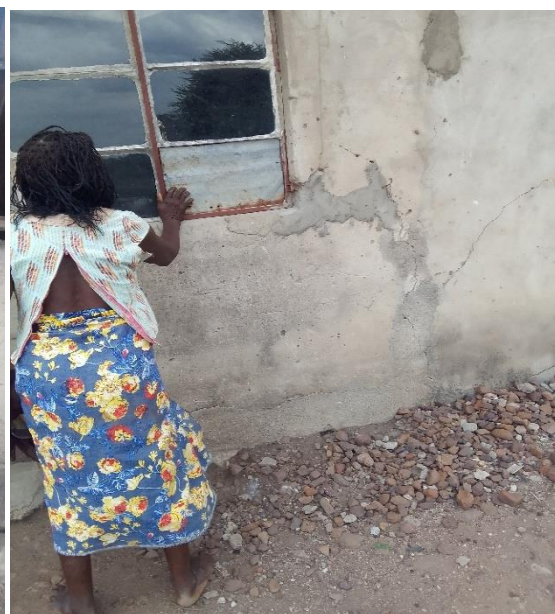
Figura 2. Vidro quebrado e substituído por chapa de zinco
