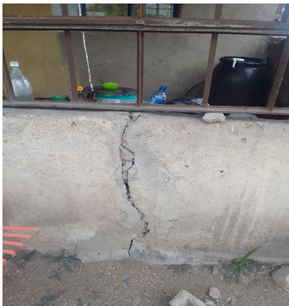
Figura 1. Rachaduras numa casa devido a vibrações
