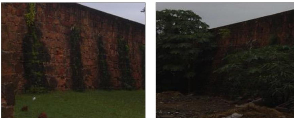
Figura.5. Efeitos de alguns elementos naturais que afectam a parte exterior das paredes da Fortaleza de Maputo (fotos de Amândia Uqueio).
