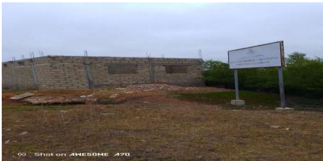
Figura 4: Construção de casas na zona do mangal
