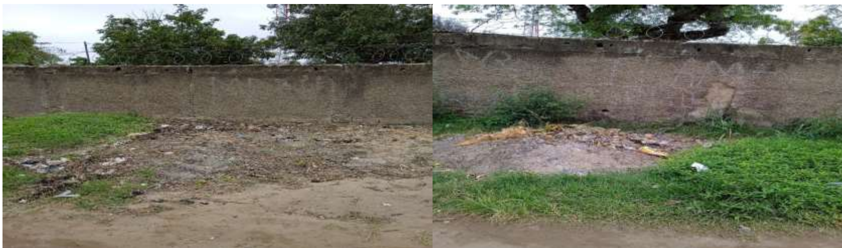
Figura 6: Infra-estrutura de vedação exterior servido de lixeira aos vizinhos da escola
