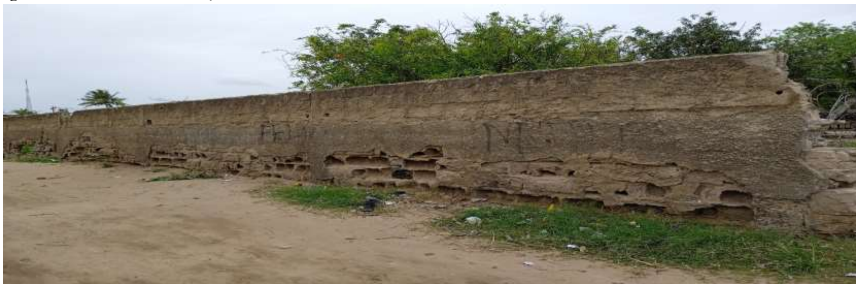
Figura 7: Infra-estrutura de vedação em degradação avançada pela urina (utentes)
