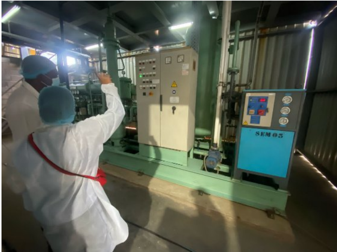
Imagem 6: Máquina compressora de ar.
