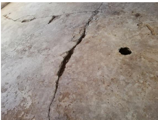
Figura XII: Ilustração do piso com fissuras.
