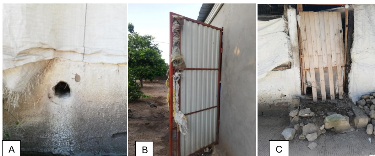
Figura IX: Ilustração do orifício A; Porta metálica B; Porta de madeira danificada com aberturas e Pedilúvio danificado C.
