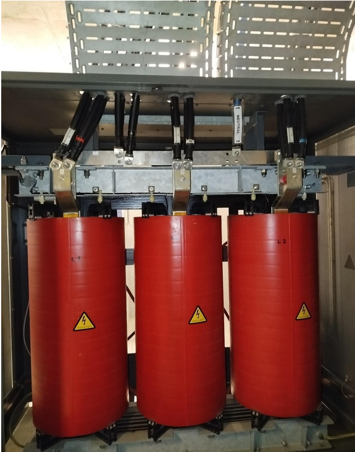
Figura A4-4: Transformador de potência de 1250 KVA
