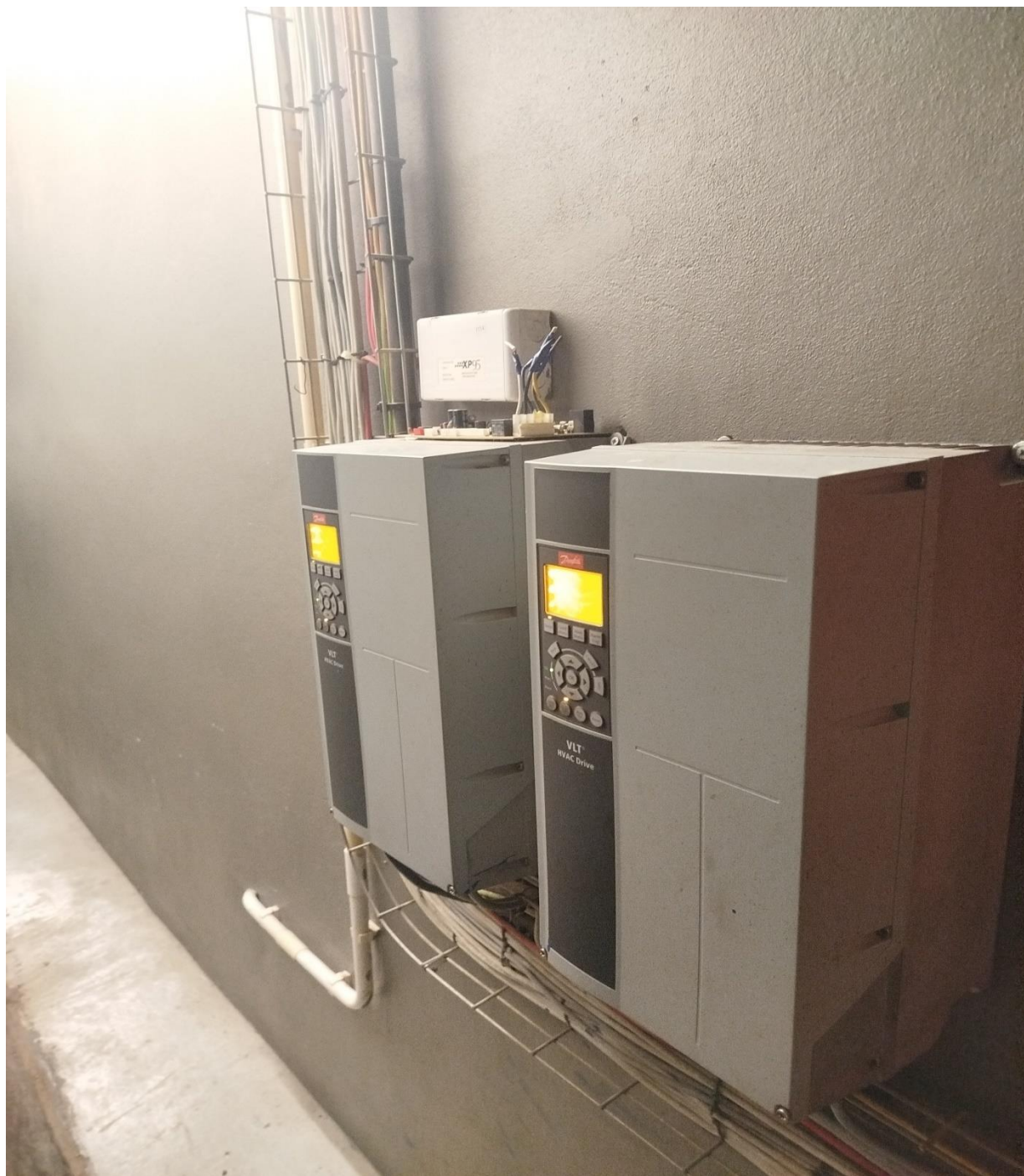
Figura A3-3: Dois (2) Variadores de Frequência instalados na sede do standart bank
