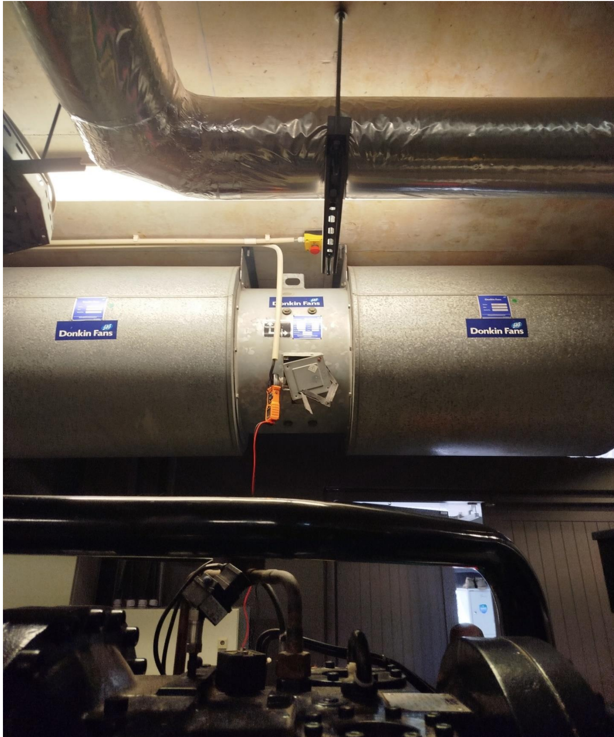
Figura A7-7: tipo de conduatas instaladas na sede do Standart bank
