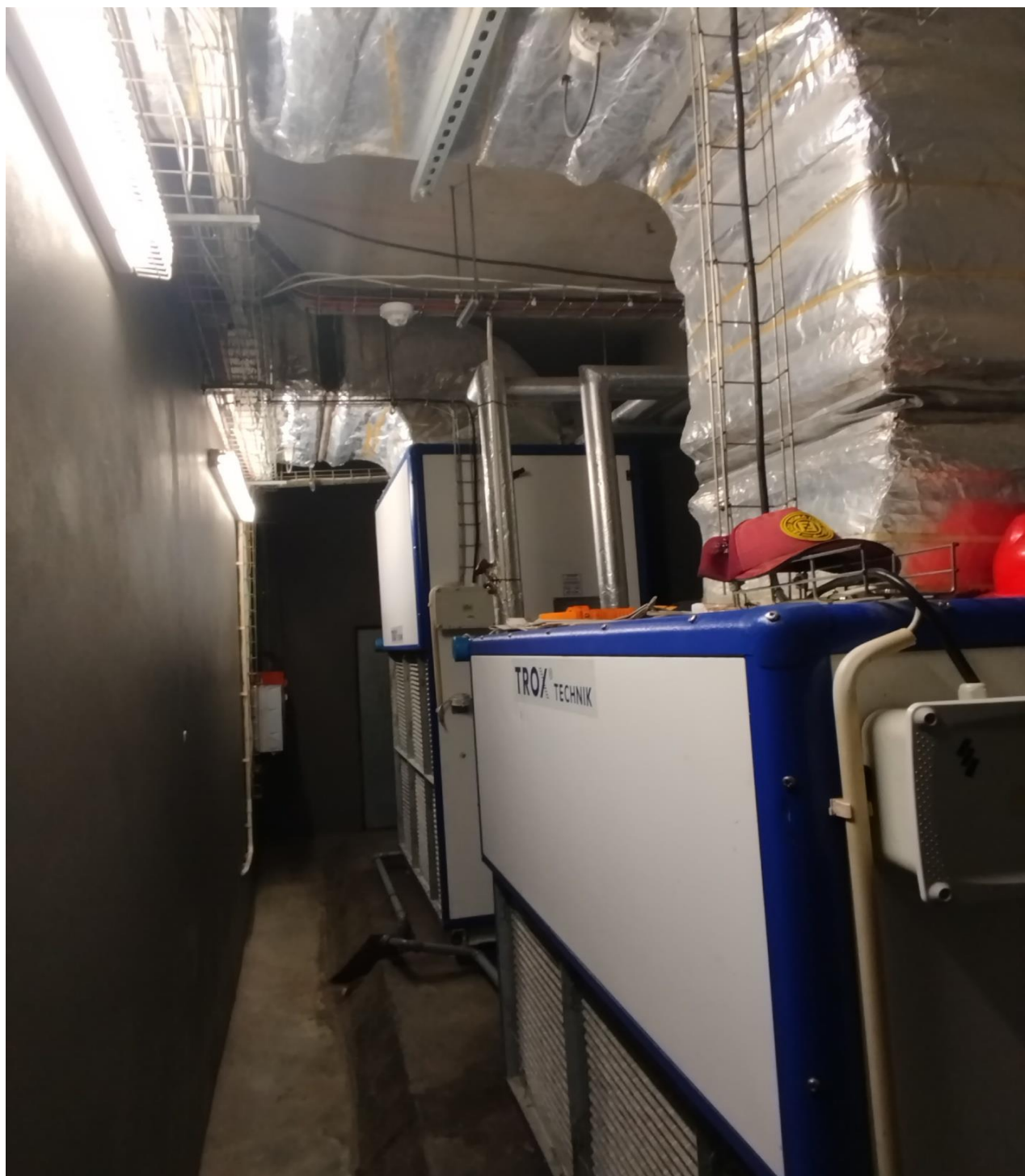
Figura A6-6: Unidades de tratamento de Ar instalados na Sede do Standart Bank
