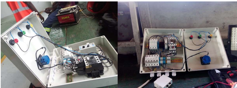
Figura 4: Ensaio e testes de relés de falta de fase e de sequência de fase (Fonte: Autor, 2025)
