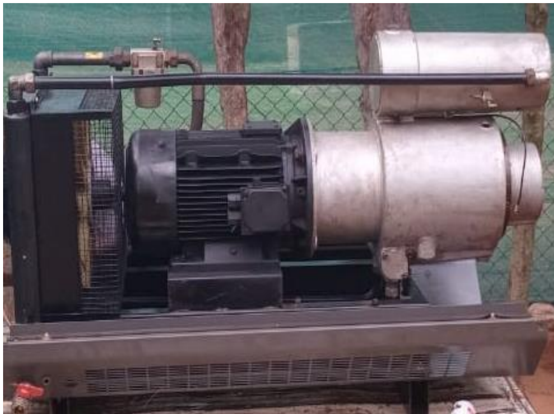
Figura A 5.1- 14. Compressor de marca EMAX. Fonte: Autor
