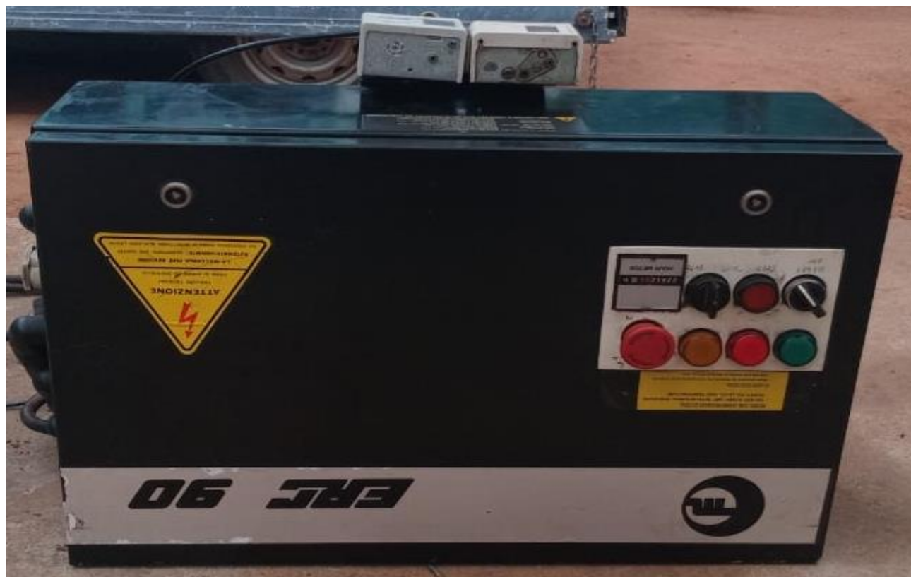
Figura A 7.1- 16. Quadro de comando do compressor e motor eléctrico. Fonte: Autor
