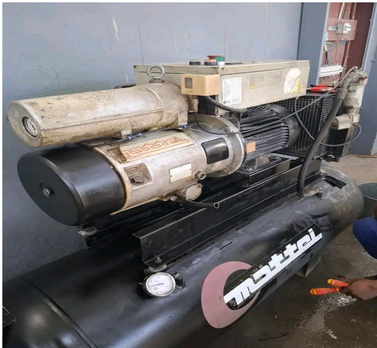
Figura A 3.1- 12 Compressor de marca Mattei. Fonte: Autor
