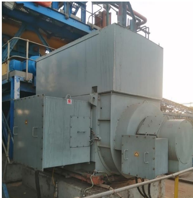
Figura 20: Motor de media tensão.
