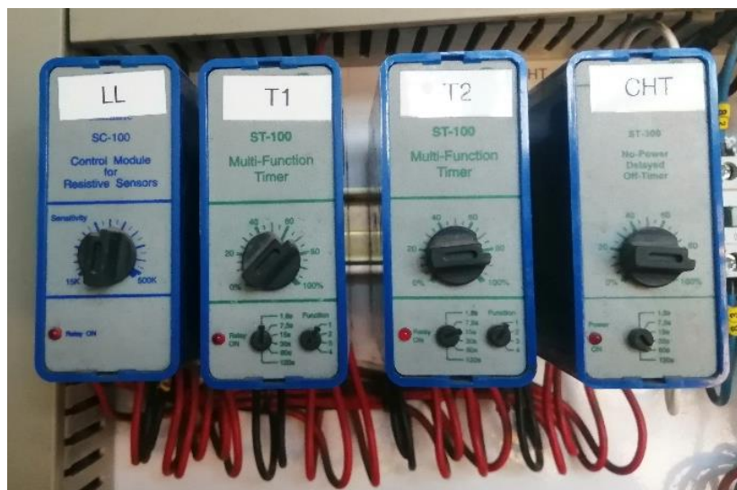
Figura A9.2-9: Temporizadores do actual sistema de controlo.
