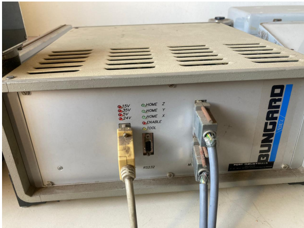
(a) O cabo responsável por conectar a fresadora a interface (fonte) está desgastado.
