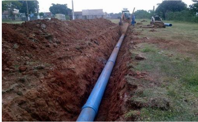
Figura 3- Tubulação de um sistema de drenagem urbana.
