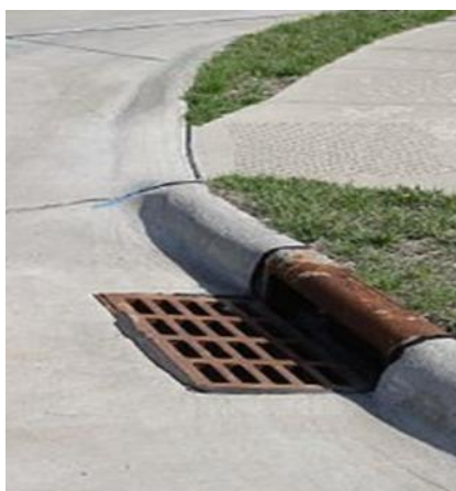
Figura 6- Boca de lobo.
