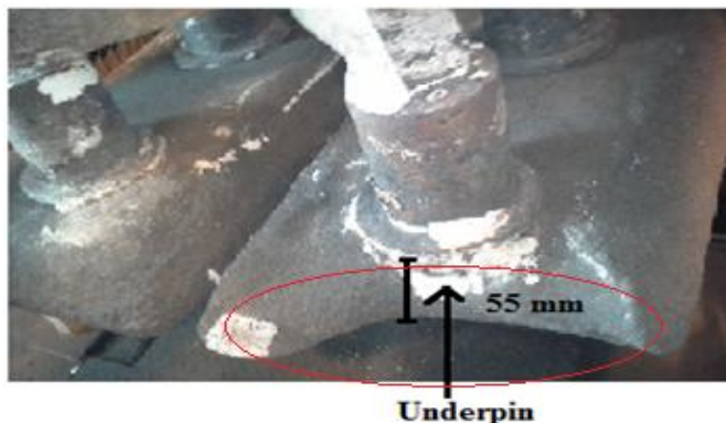
Figura 43. Imagem que ilustra o impacto da oxidação do ar no underpin.
