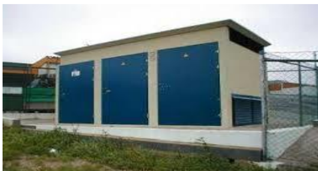
Figura 5. PT do tipo armário. (Fonte: Piloto, 2024).
