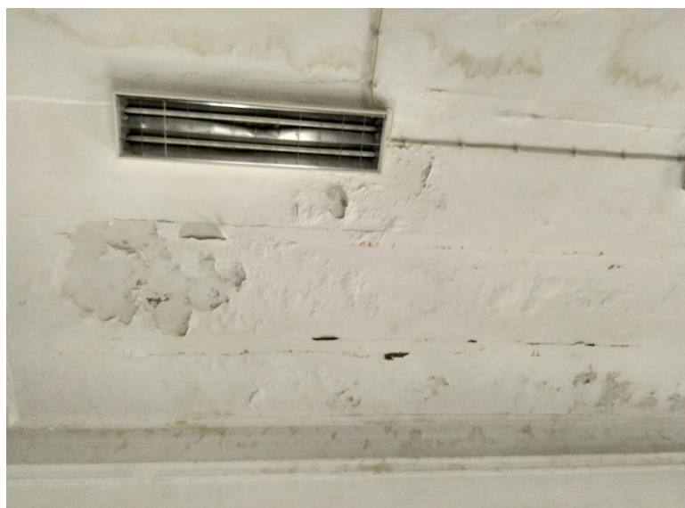
Figura 05- parte do edifício com vestígios de partes danificas por onde a infiltração de água adentra a biblioteca.
