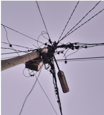
Figura 1: Rede aérea de BT em torçada do bairro zona verde ( Fonte: Autor, 2024 )
