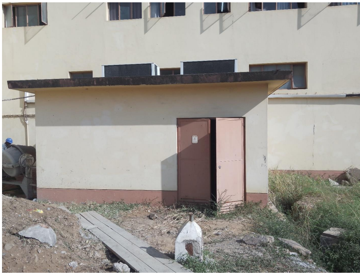
Figura A4- 1: PT 500kVA DEEL. Fonte: Autor
