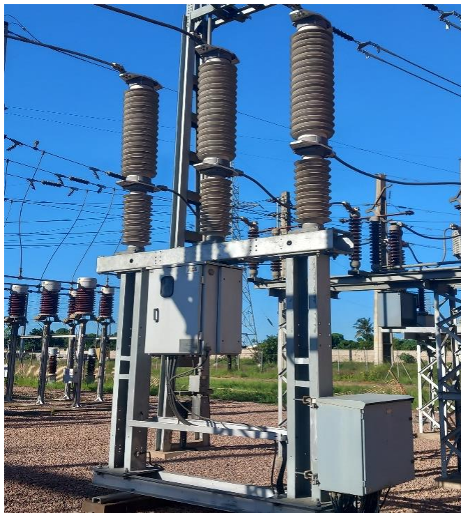
Figura 6: Disjuntor a SF6 e respectivo símbolo (Fonte: O Autor, 2024)
