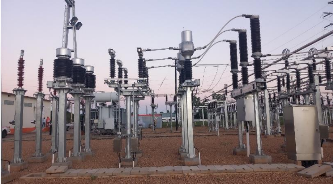
Figura 4:Exemplo de um painel eléctrico exterior (Fonte: O Autor, 2024)
