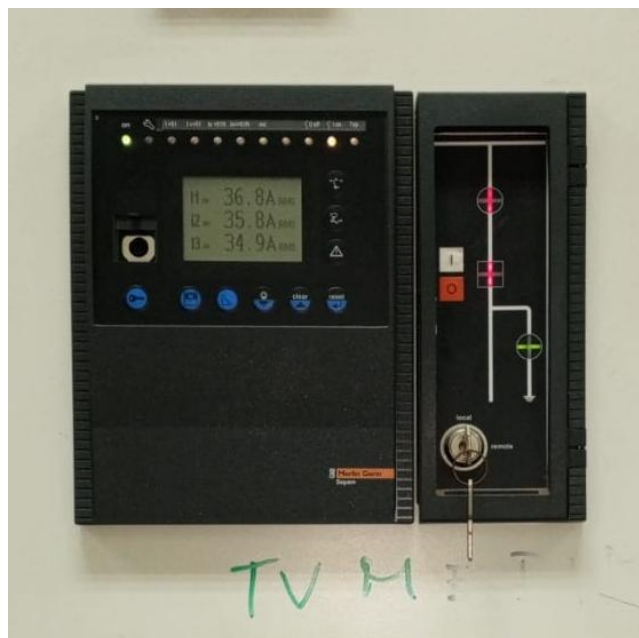
figura 27 - relé de proteção digital circuito da televisão de moçambique no PS 14 [FONTE: AUTOR]
