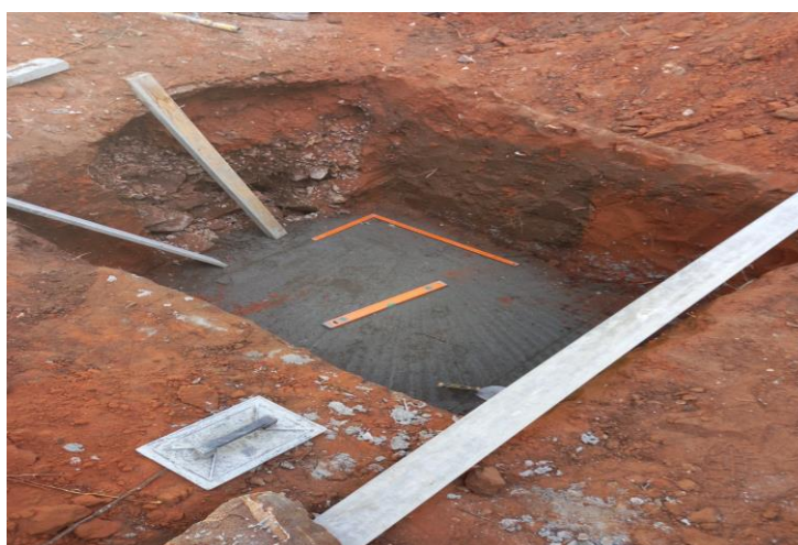
Figura 19 – Aplicação de betão de limpeza da caixa de retenção de gorduras (Fonte: Própria)
