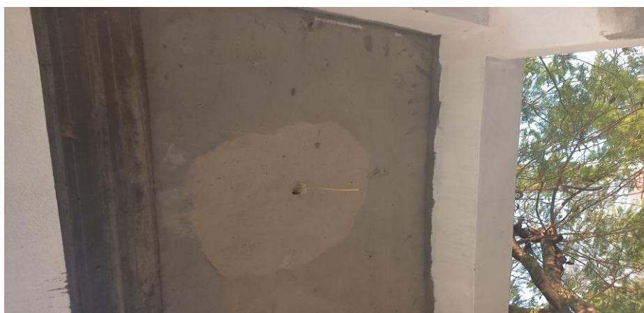
Figura 41 – Descontinuidade na lajeta da guarita (Fonte: Própria)
