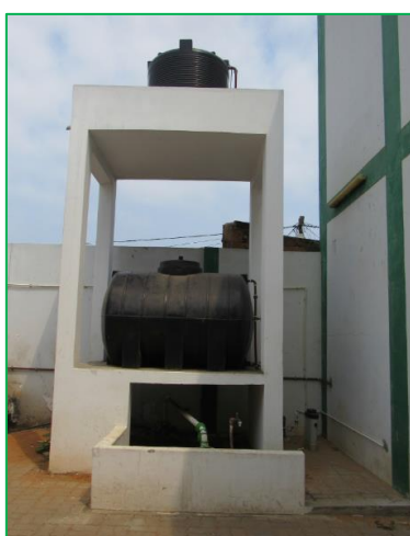
Figura 6: Sistema de captação, armazenamento e abastecimento de água
