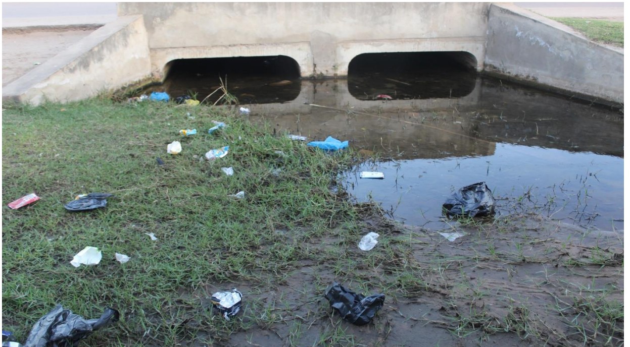
Apêndice 4: Ponteca construída para retenção da água cheia e com presença de lixo.
