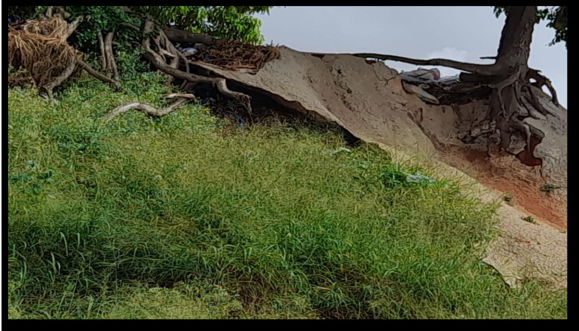
Anexo 4: Talude do lado esquerdo - Cobertura superficial do talude danificada (sentido Polana - Praça dos Combatentes)
