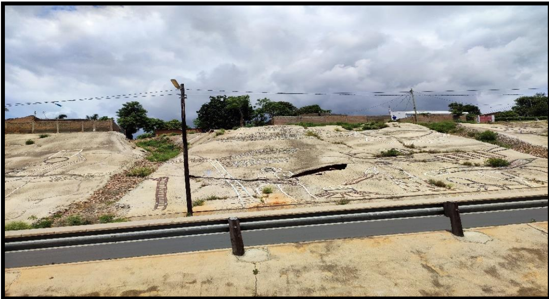
Anexo 5: Talude do lado esquerdo - aparecimento de crateras no corpo do talude (sentido Polana - Praça dos Combatentes)
