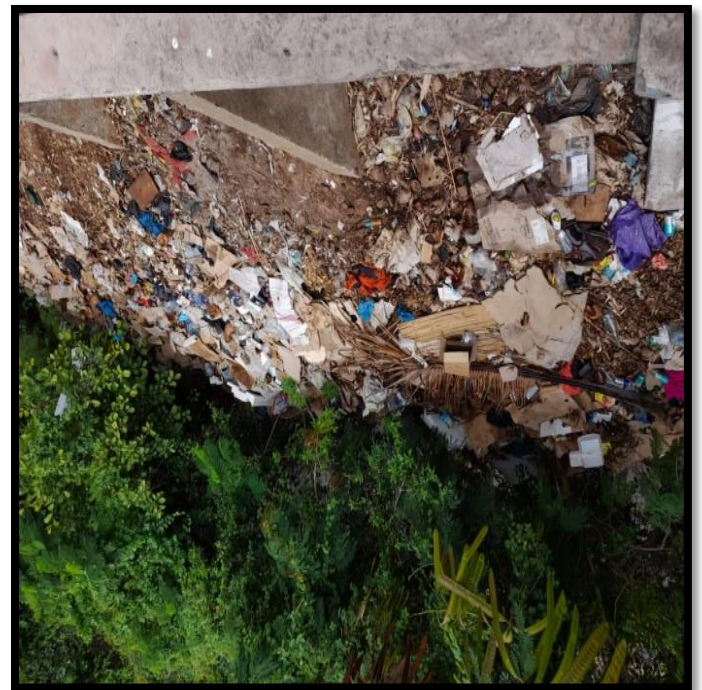
Anexo 3: Deposição de lixo na crista do talude P.V
