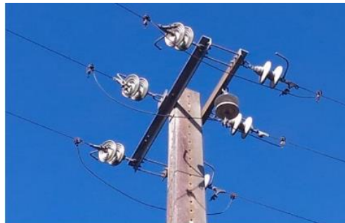
Figura 5. Isoladores inseridos em cadeia de amarração no apoio.
