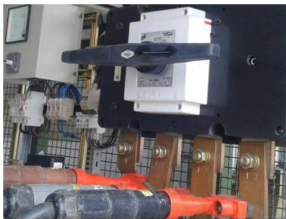
Figura 17. Barramentos com identificação de fases e do neutro.
