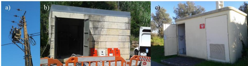
Figura 14. Modo de construção de PT's em: a) poste, b) cabine baixa, c) monobloco.
