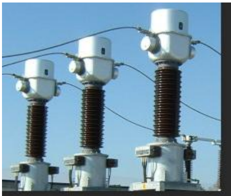
Figura 6: transformador de corrente
