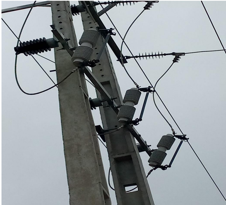
Figura 3. 4:Seccionadores tipo Dop-out fuse link
