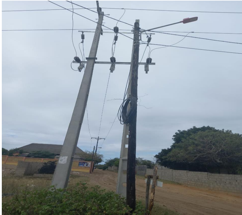
Figura 3. 6: Ponto de Seccionamento 4.
