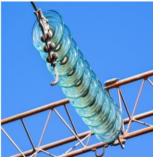
Figura 2. 4: Isoladores de vidro Fonte: (www.siklo.com.br)
