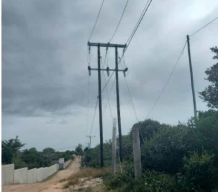
Figura 3. 5: Ponto de Seccionamento 3
