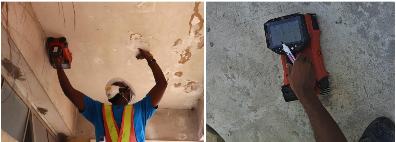
(a). Detecção na face inferior da laje.
