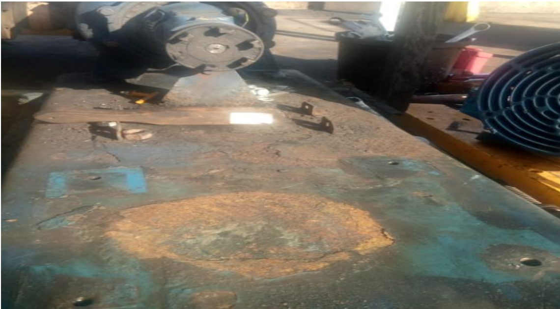
Figura 32: Base do motor oxidada
