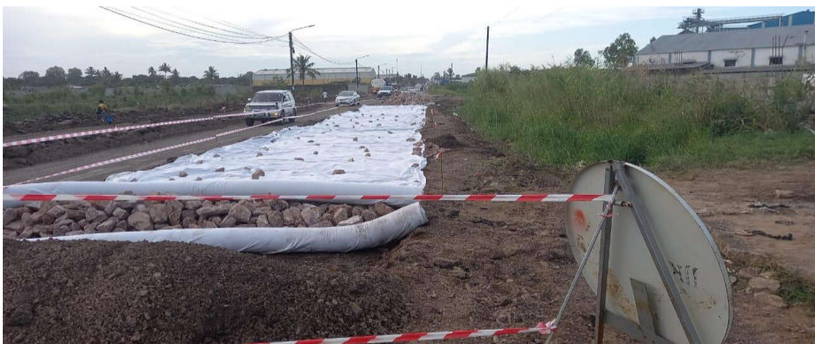
Figura 64: Dreno de inerte (km 0+250) – Fonte: Adaptado pelo autor (2022)
