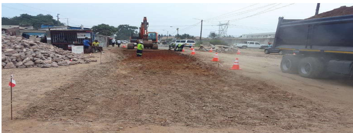
Figura 47: Abertura da caixa do drift (km 5+795) – Fonte: Adaptado pelo autor (2022)
