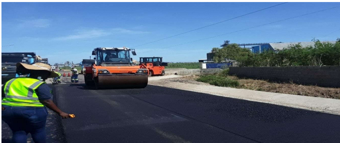
Figura 90: Medição da temperatura e compactação do betão betuminoso com o cilindro estático liso (km 0+250) – Fonte: Adaptado pelo autor (2023)
