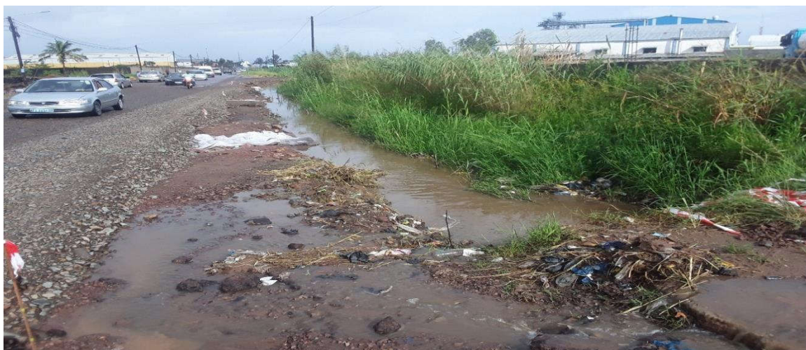
Figura 33: Situação da valeta existente depois das chuvas (Estrada R807: Coca-Cola/ Matola-Gare – Coca-Cola) – Fonte: Adaptado pelo autor (2022)
