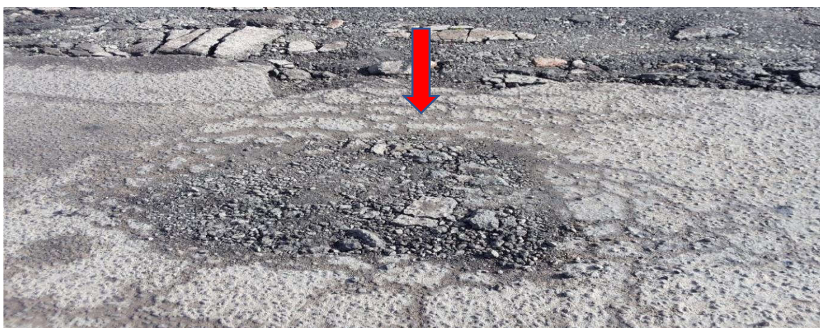
Figura 21: Patologia tipo pele de crocodilo (Estrada R807: Coca-Cola/ Matola-Gare – Coca-Cola) – Fonte: Adaptado pelo autor (2022)
