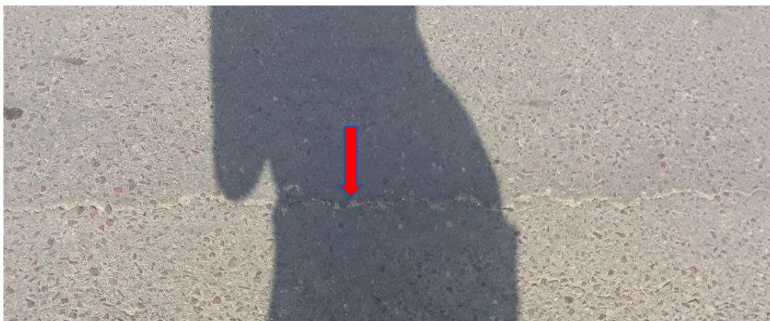
Figura 22: Patologia tipo fissura longitudinal (Estrada R807: Coca-Cola/ Matola-Gare – Mafurreira) – Fonte: Adaptado pelo autor (2022)
