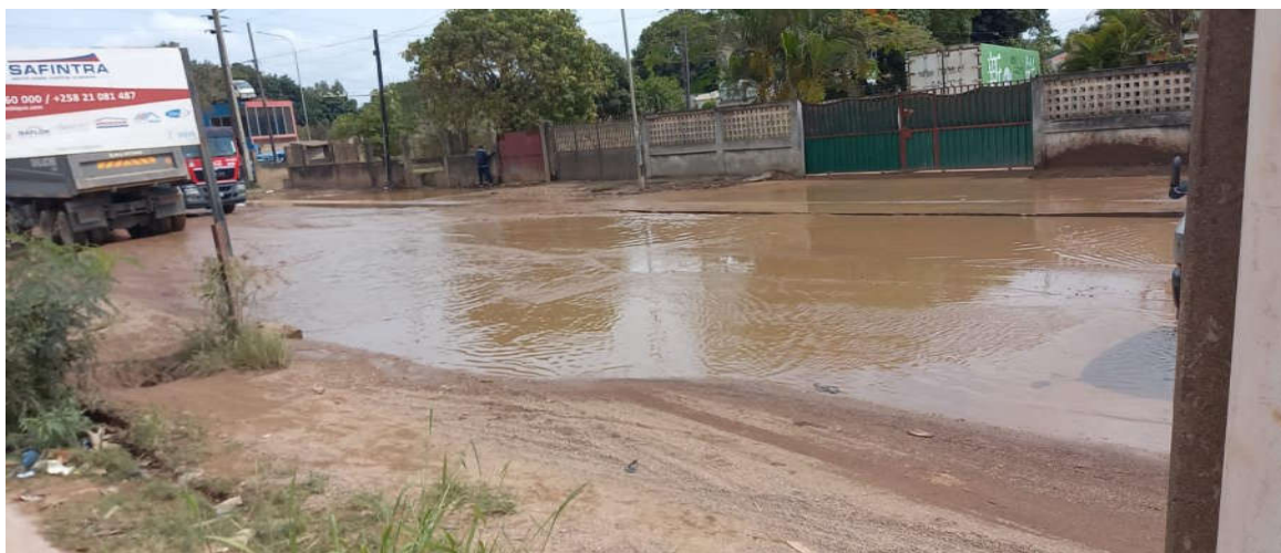
Figura 30: Estado do pavimento existente devido a problemas de drenagem (Estrada R807: Coca-Cola/ Matola-Gare – Mafurreira) – Fonte: Adaptado pelo autor (2022)
