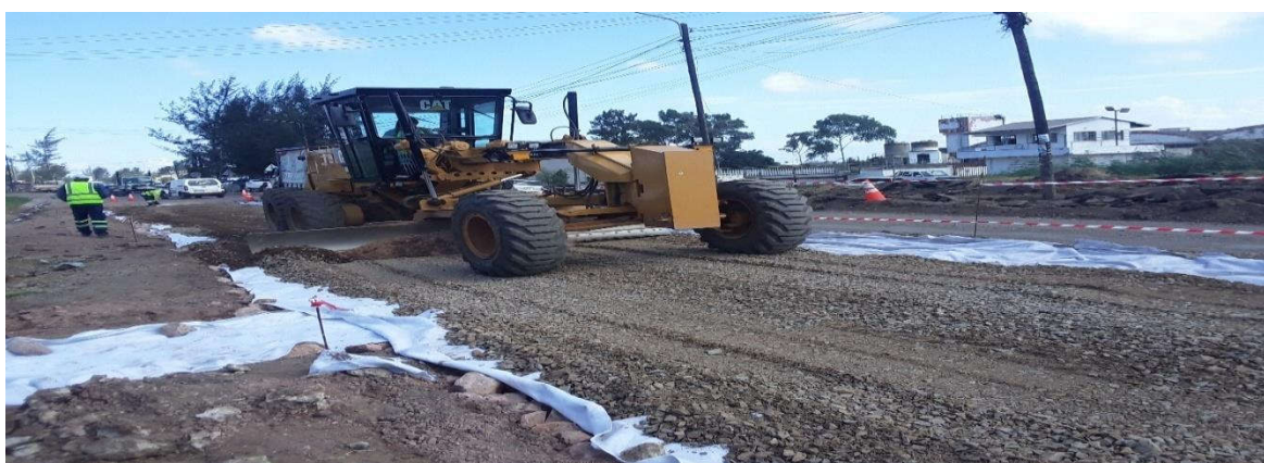
Figura 66: Espalhamento do material para a camada de sub-base (km 0+250) – Fonte: Adaptado pelo autor (2022)
