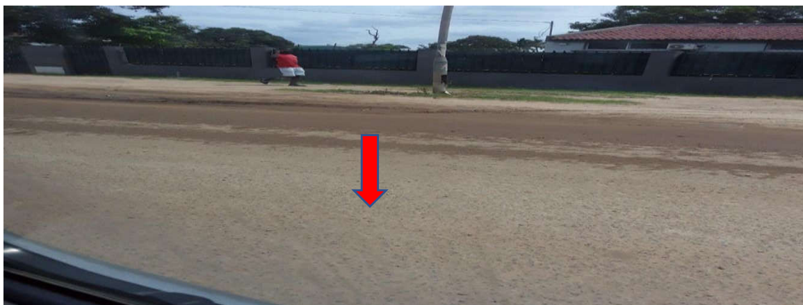
Figura 17: Patologia tipo desgaste do revestimento (Estrada R807: Coca-Cola/ Matola-Gare – Mafurreira) – Fonte: Adaptado pelo autor (2022)
