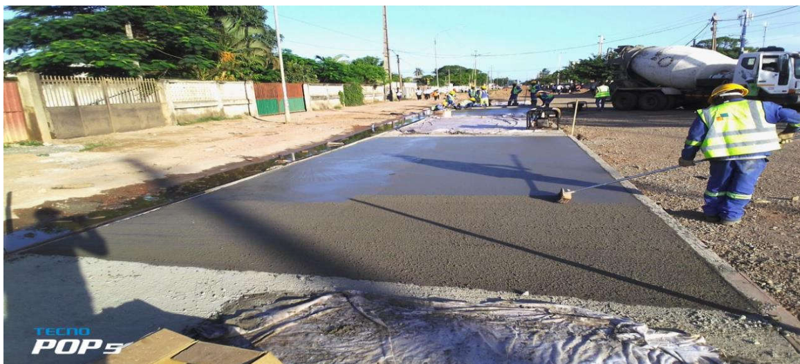
Figura 102: Tratamento superficial da laje (km 3+200) – Fonte: Adaptado pelo autor (2023)
