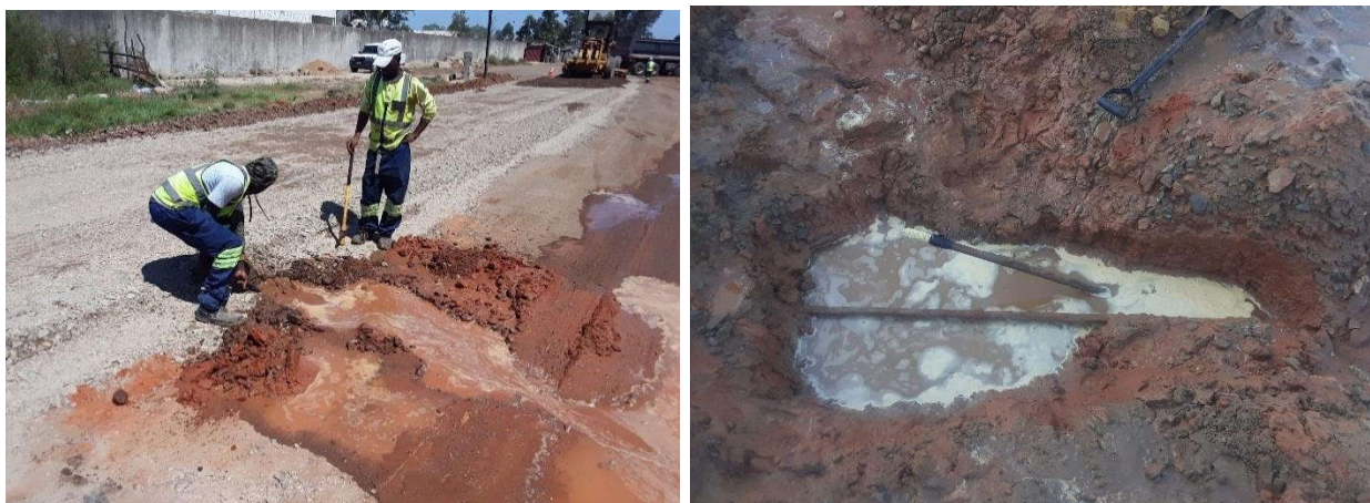
Figura 81: Rompimento de tubos de distribuição de água potável (km 5+795) – Fonte: Adaptado pelo autor (2022)
