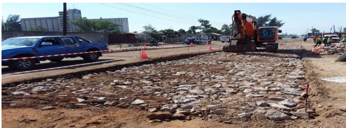
Figura 48: Colocação e compactação da camada de rachão (km 5+795) – Fonte: Adaptado pelo autor (2022)
