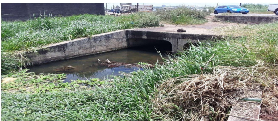
Figura 35: Situação da passagem húmida existente (Estrada R807: Coca-Cola/ Matola-Gare – Coca-Cola) – Fonte: Adaptado pelo autor (2022)
