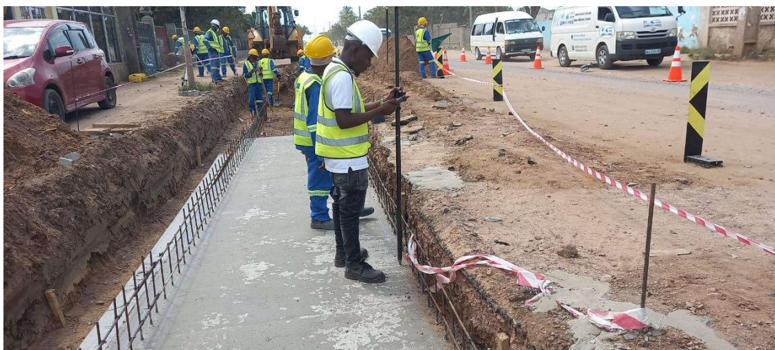
Figura 112: Verificação das cotas da laje de fundo da vala rectangular (km 3+200) – Fonte: Adaptado pelo autor (2022)
