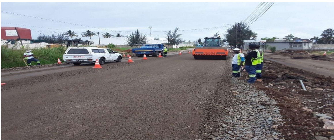
Figura 68: Compactação da plataforma com cilindro de rolo liso (km 0+250) – Fonte: Adaptado pelo autor (2022)
