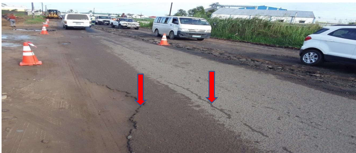
Figura 24: Patologias tipos fissura longitudinal e falha na aresta (Estrada R807: Coca-Cola/ Matola-Gare – Coca-Cola) – Fonte: Adaptado pelo autor (2022)
