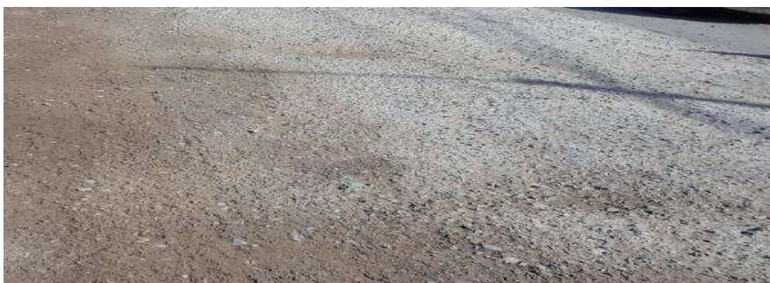
Figura 84: Faixa de rodagem após a limpeza (km 0+250) – Fonte: Adaptado pelo autor (2023)
