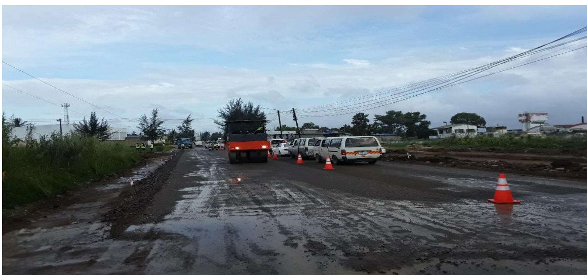
Figura 69: Compactação da plataforma com compactador rolo pneumático (km 0+250) – Fonte: Adaptado pelo autor (2022)
