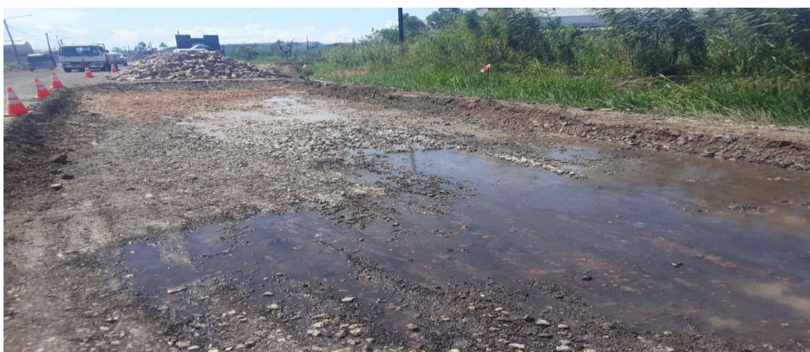
Figura 60: Abertura da caixa do dreno de inerte (km 0+250) – Fonte: Adaptado pelo autor (2022)
