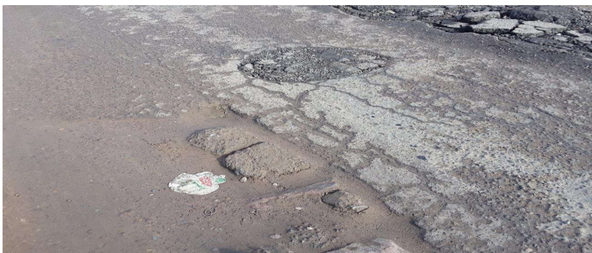
Figura 25: Patologias diversas (Estrada R807: Coca-Cola/ Matola-Gare – Coca-Cola) – Fonte: Adaptado pelo autor (2022)
