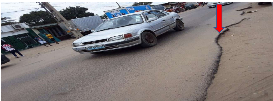
Figura 19: Patologia tipo falha na aresta (Estrada R807: Coca-Cola/ Matola-Gare) – Fonte: Adaptado pelo autor (2022)
