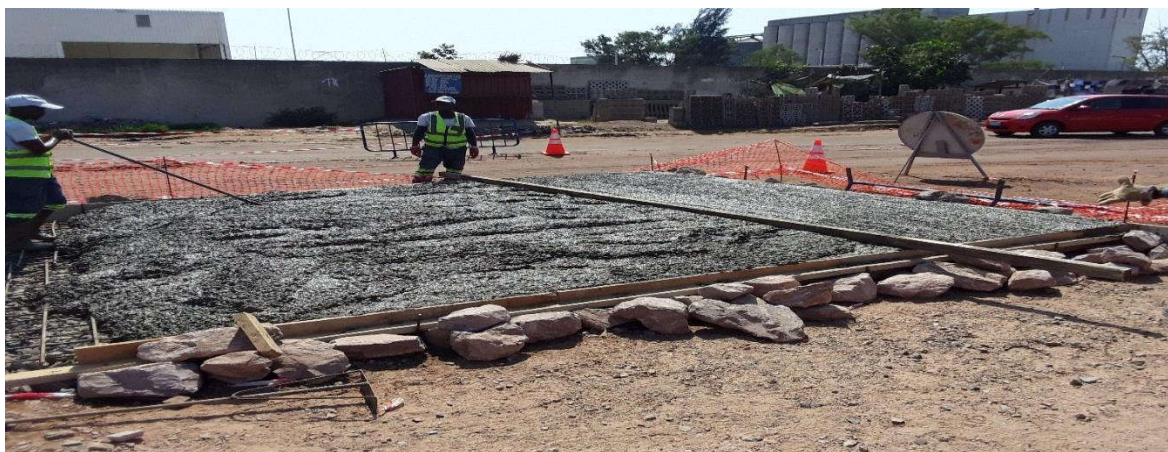
Figura 53: Nivelamento e regularização da superfície de rodagem (km 5+795) – Fonte: Adaptado pelo autor (2022)
