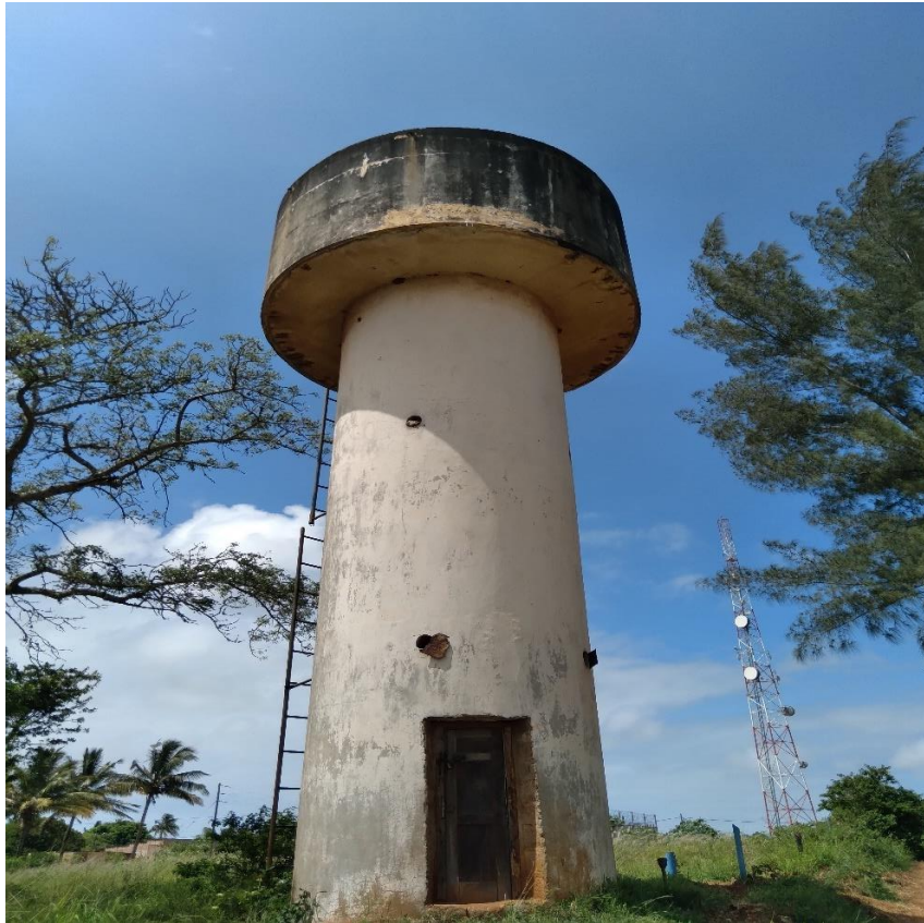
Figura 12- Reservatório de Chongoene
