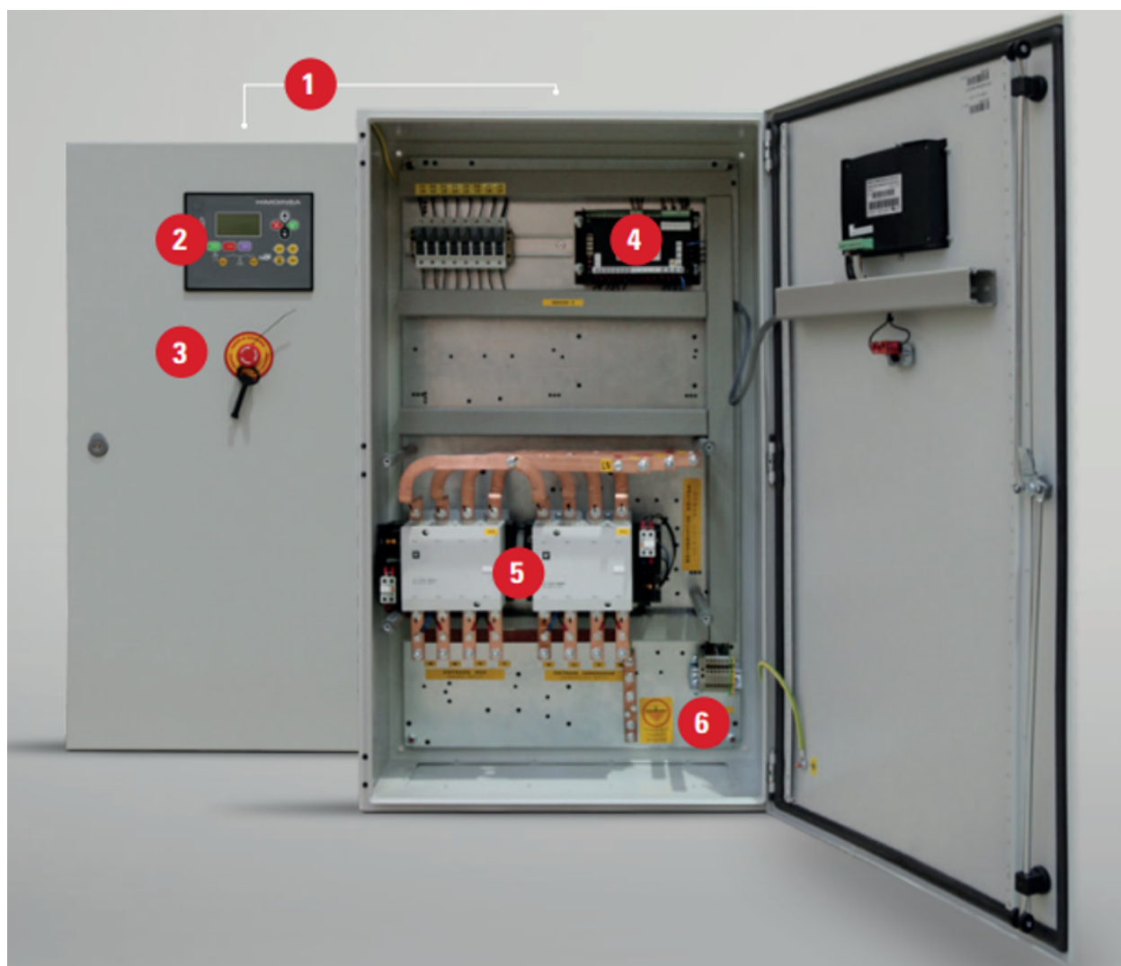
Figura 2.14: Quadro de transferência automática
