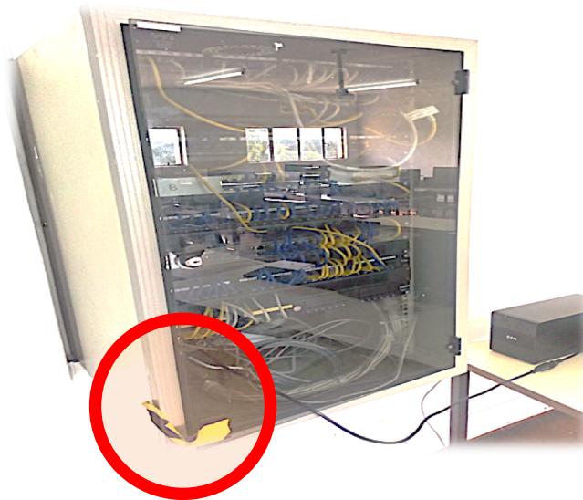
Figura 32: Armário de dispositivos da rede
