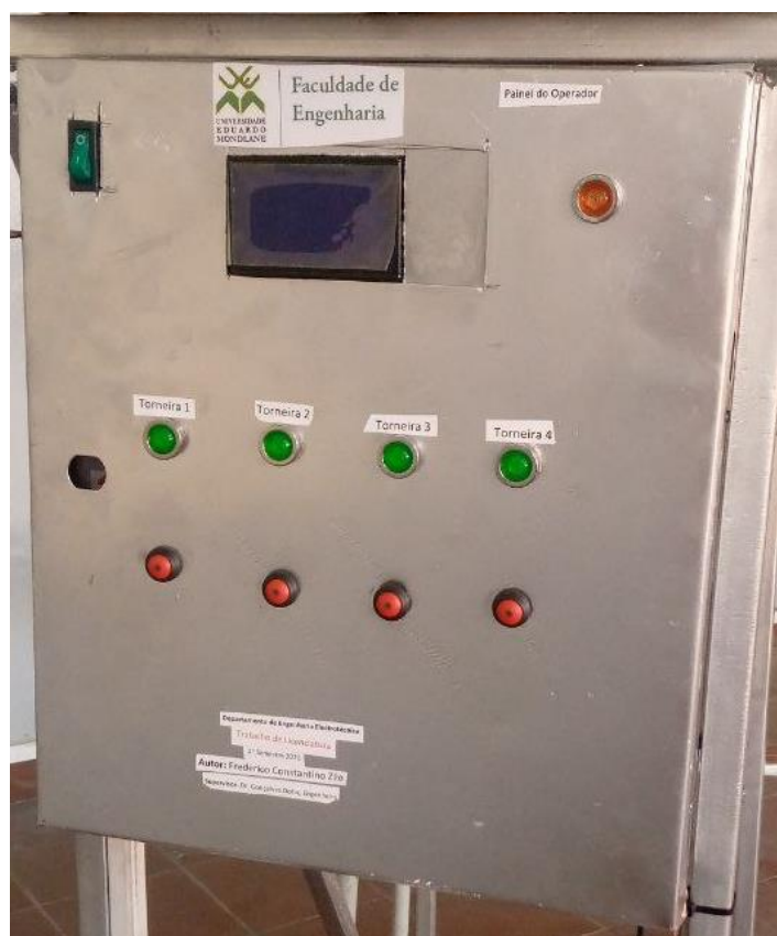
Figura 4- 4: Painel do operador (Fonte: Autor)
