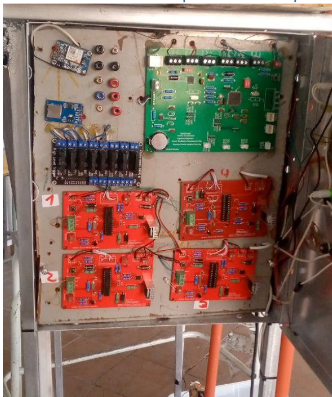
Figura 4- 6 : Parte interna do painel do operador (Fonte: Autor)
