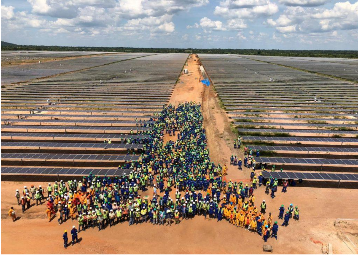
Figura 2- Central Solar de Mocuba
