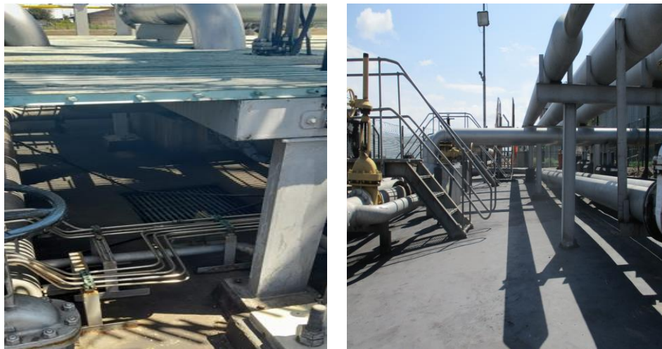
Figura 3.20: Bacia de retenção do Cais P3 (à esquerda) e dos manifolds (à direita).
