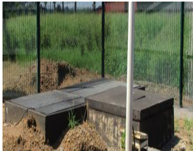
Figura 3.15: Tanque de separação nos manifolds .
