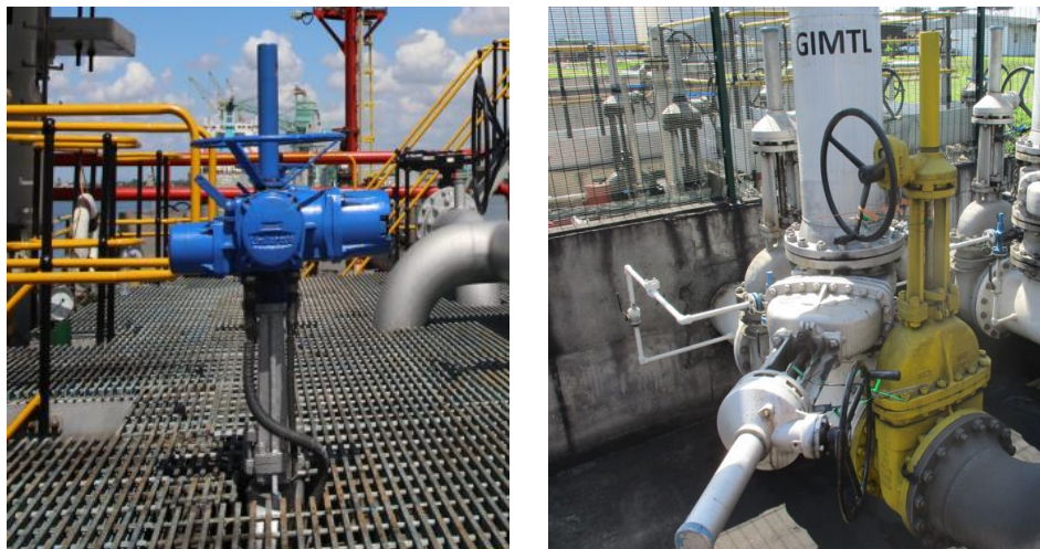
Figura 3.11: Válvulas de bloqueio.
