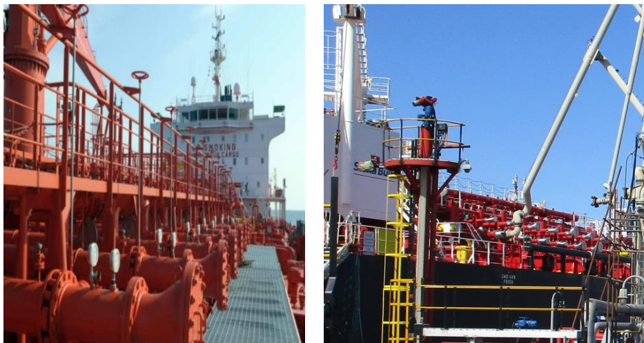
Figura 3.16: Manifold do navio-tanque (à esquerda) e braço de carga conectado ao manifold do navio-tanque (à direita).
