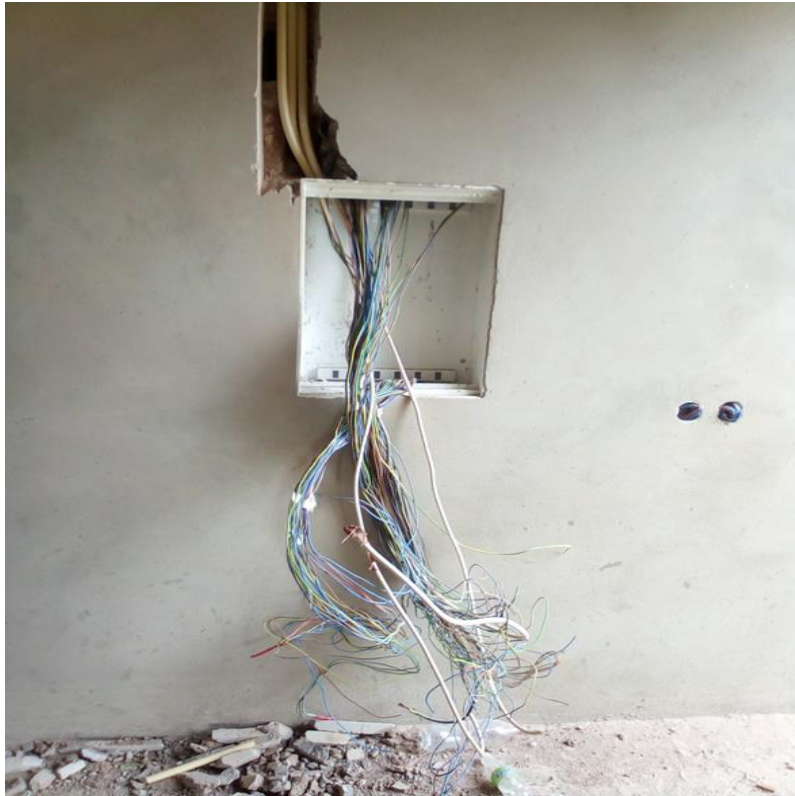
Figura 23 Quadro eléctrico geral com vários circuitos
