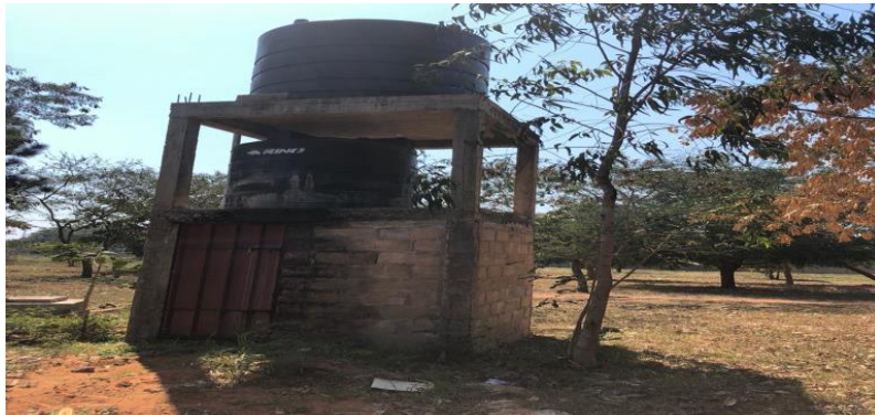
Figura 4.2: Tanque de armazenamento de água
