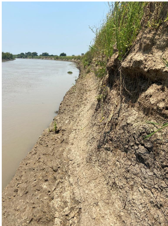
Figura 4.20- Vista do talude da margem do rio mesmo à frente da torre desprovida de vegetação e exposta à erosão
