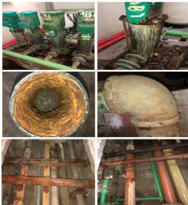
Figura 28. Corrosão de fuga de água e desgaste natural de uso.
