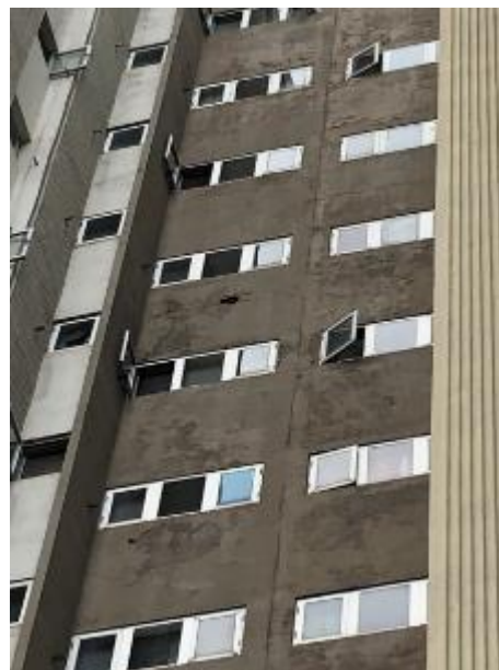
Figura 23. Manchas e humidade.
