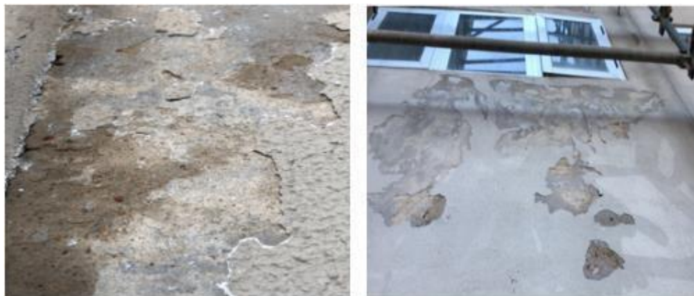
Figura 24. Empolamento e desgaste da pintura.
