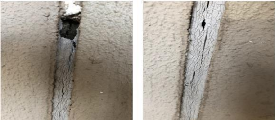
Figura 27. Deterioração do material de enchimento da junta de dilatação.
