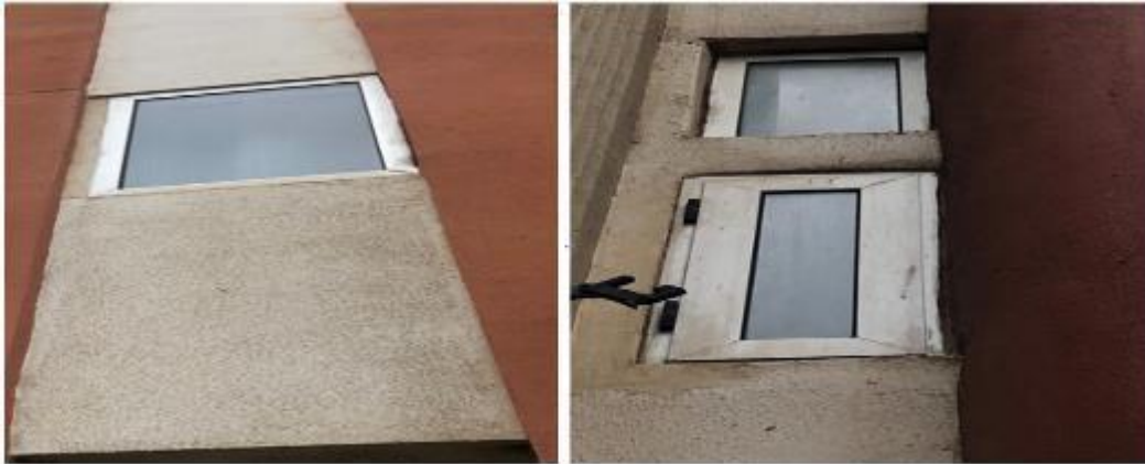
Figura 17. Manchas escuras nas paredes dos vãos das janelas.
