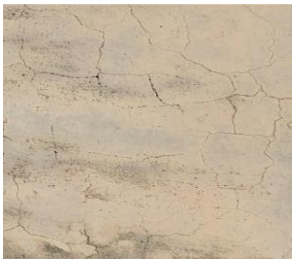
Figura 5. Fissuras em paredes.
