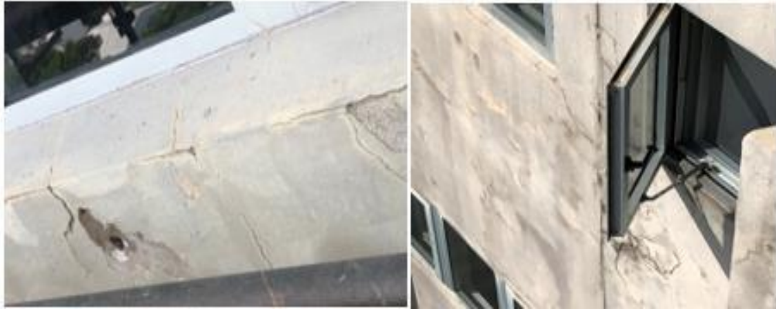
Figura 22. Fissuração em peitoril da janela.
