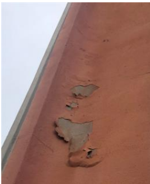
Figura 1. Descasque da pintura.
