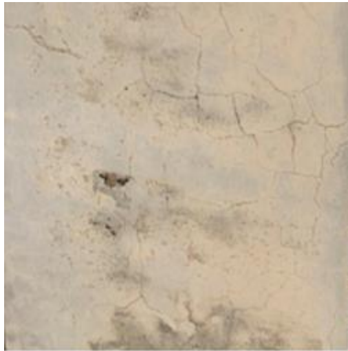
Figura 20. Descoloração da pintura.
