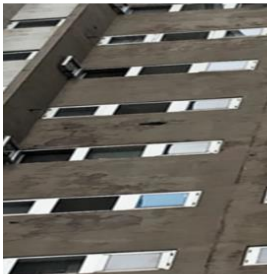
Figura 3. Humidade em paredes.
