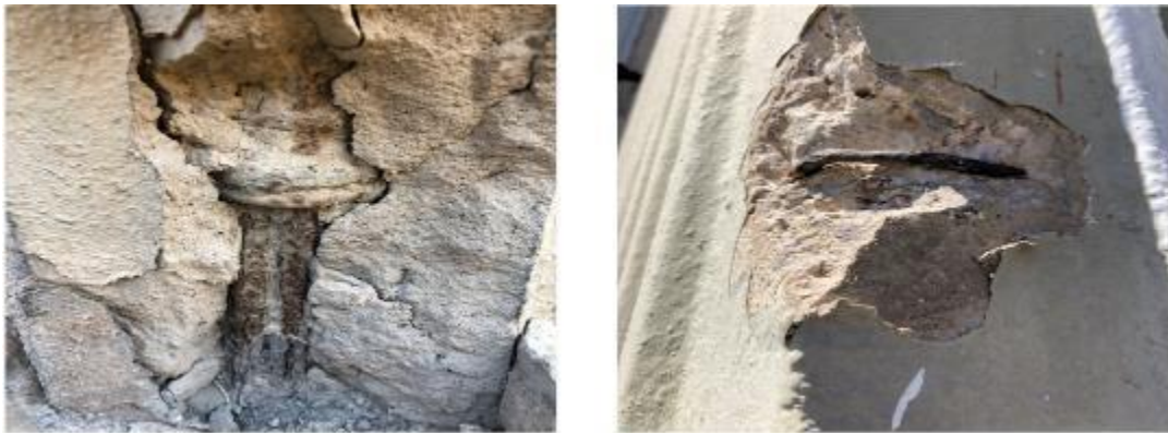
Figura 19. Destacamento do betão e corrosão da armadura.
