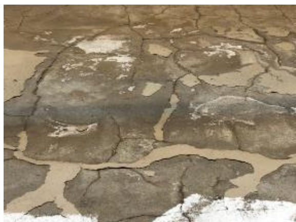
Figura 25. Fissuração grave de reboco.
