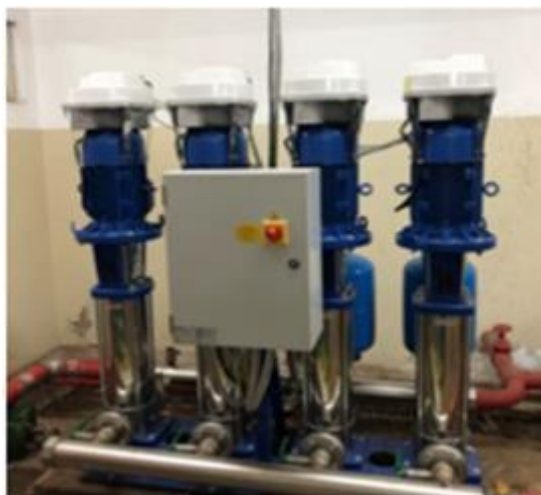
Figura 8. Bombas de velocidade variável
