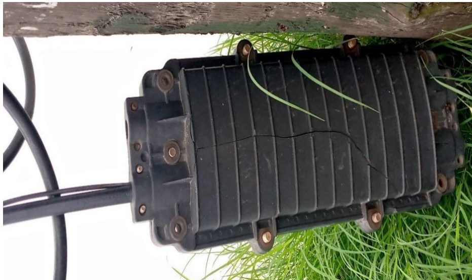
Figura 14: Amplificador de Sinal em Rede de Transporte HFC, (Fonte: O autor)
