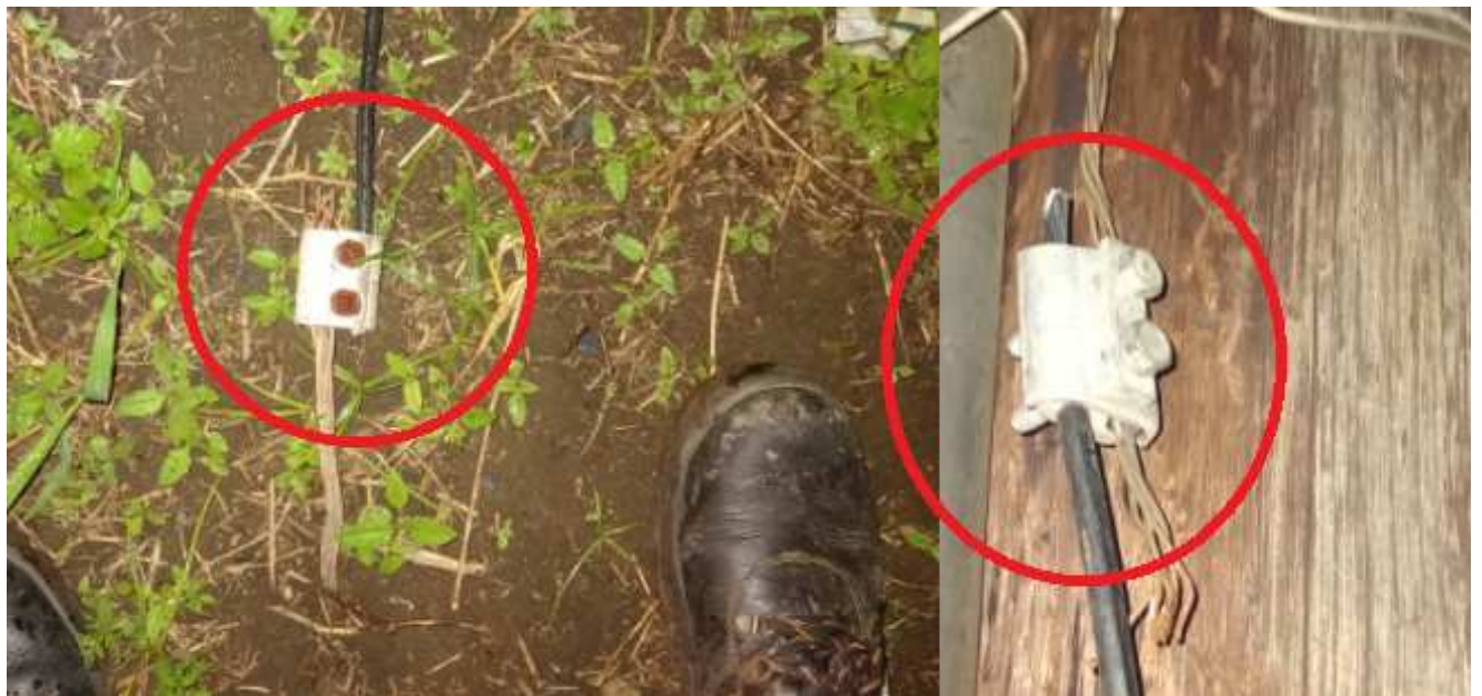
Figura 21: Conexão no condutor do sistema de aterramento
