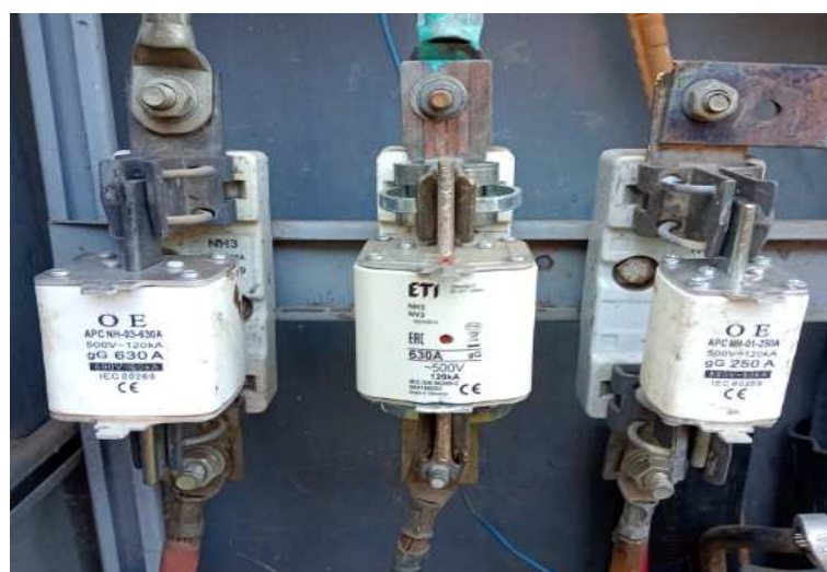
Figura 11: Calibre dos fusíveis gerais no QGBT
