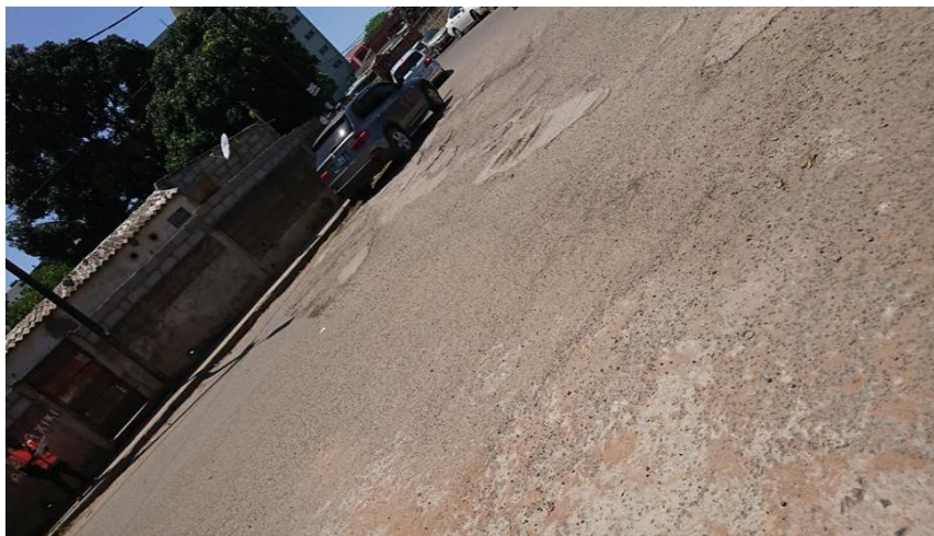
Figura 14: Patologia de degradação superficial
