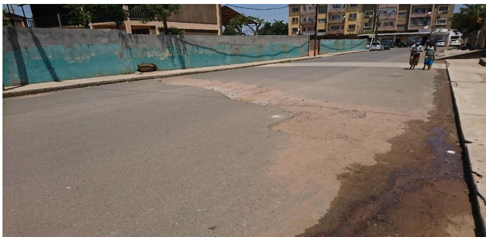
Figura 18: Patologia de passagem de serviços
