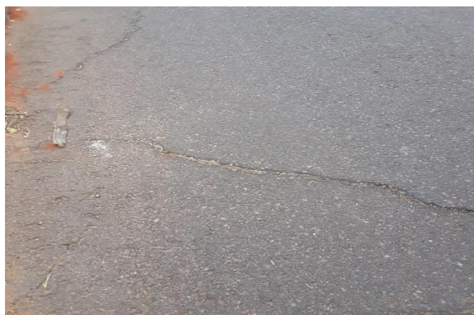
Figura 13: Patologia de Fissura nos pavimentos
