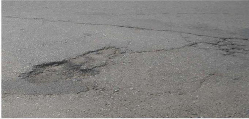
Figura 15: Patologia de Decapagem
