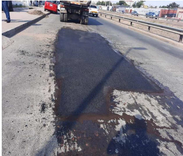
Figura 17: Patologia de Remendos
