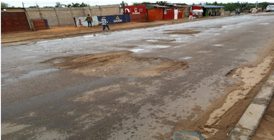
Figura 16: Patologia de Buracos
