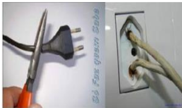
Figura 7. Corte da ficha e partes energizadas aparentes [05]
