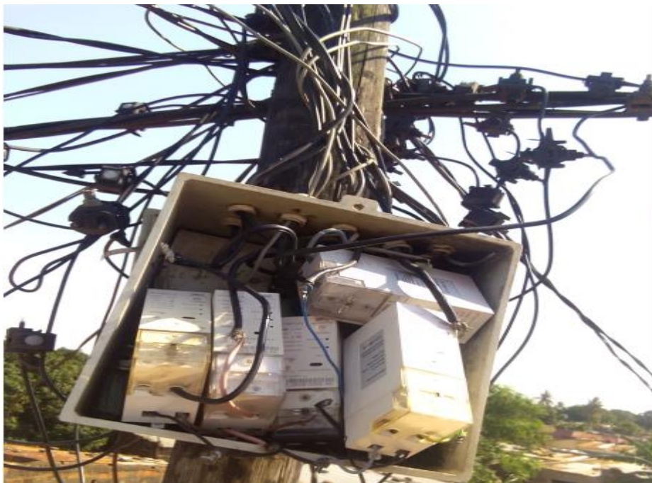
Figura 14. Ilustração de postes de distribuição de energia eléctrica tem um número de baixadas superior a 10
