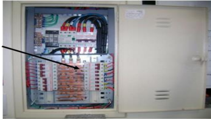
Figura 5. Barramento vivo de um quadro de distribuição [04]
