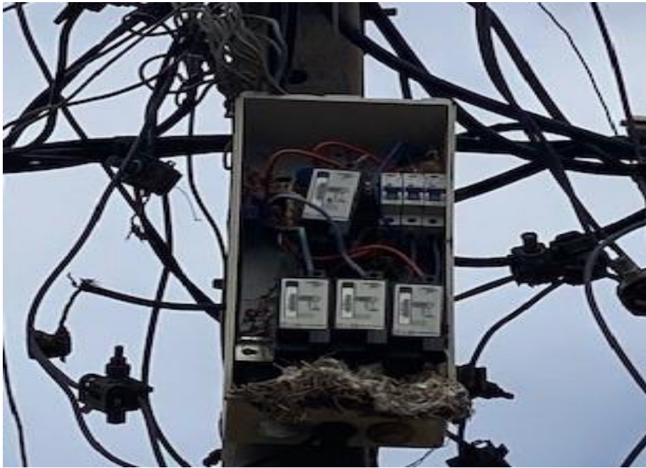
Figura 15. Ilustração de cabos com má ligação e contadores fora de protecção
