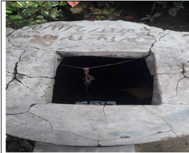
Poço 1- Bairro Inhangome
