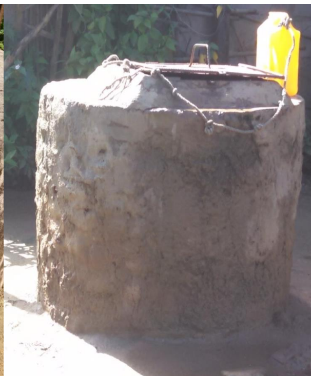
Fotografia2. Poço 1 do bairro 25 de Setembro.
