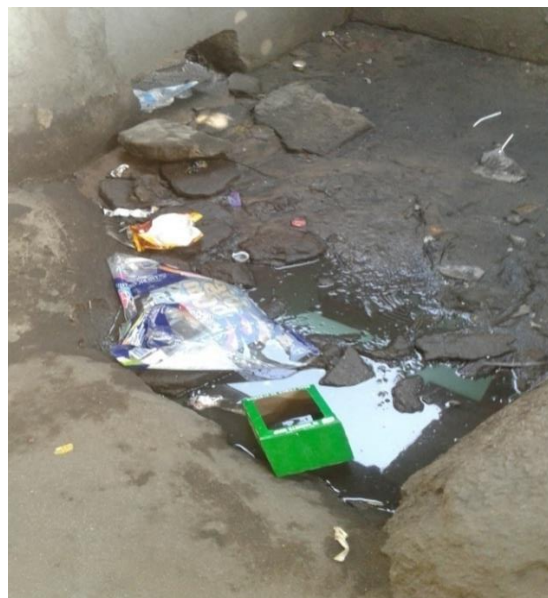
Figura 4.3. Águas residuais provenientes dos sanitários
