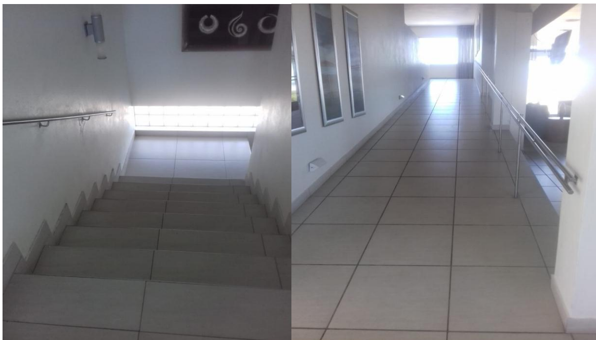
Fig 7 e 8 – Corrimão e Rampa que dá acesso aos quartos e Piscina do Hotel Casa do Capitão
